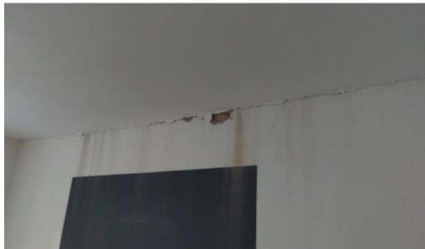
Slika 5.20 Karakteristično odvajanje zabatnog zida i međukatne konstrukcije
