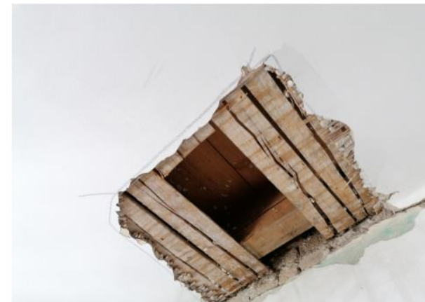
Slika 5.47 Sondažna bušotina 18 – Drveni grednik, zablatni zid
