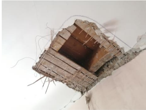
Slika 5.42 Sondažna bušotina 14 – Drveni grednik, zablatni zid
