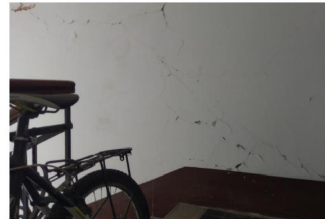
Slika 5.10 Pukotine u stubišnom zidu u potkrovlju
