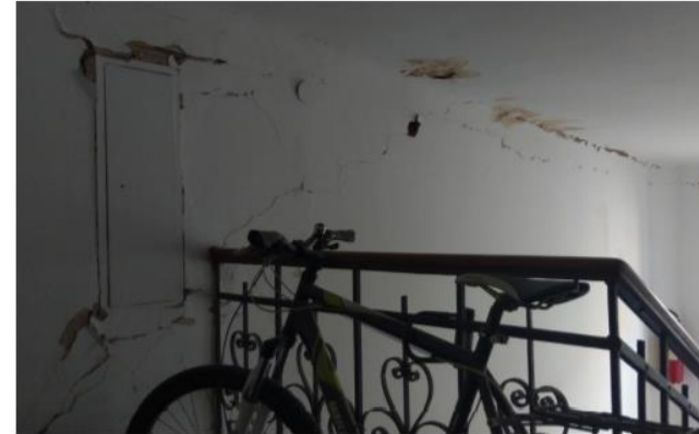
Slika 5.9 Pukotine u stubišnom zidu u potkrovlju i na spoju s krovnom konstrukcijom
