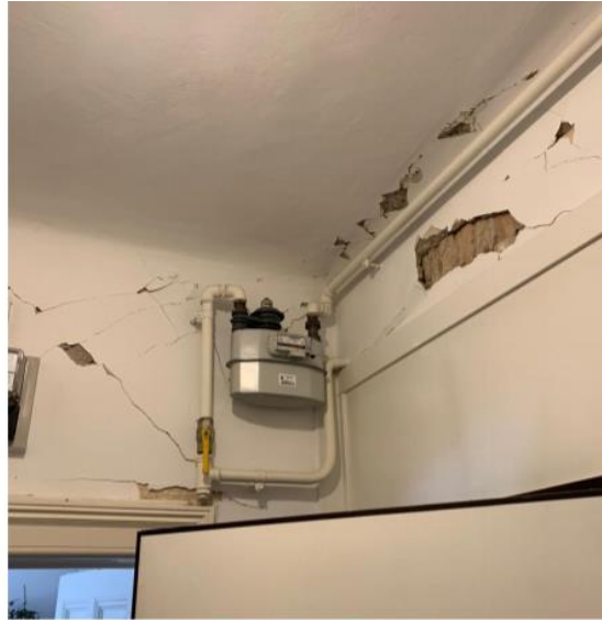
Slika 5.19 Pukotine u nadvojima pregradnog (lijevo) i nosivog zida (desno)
